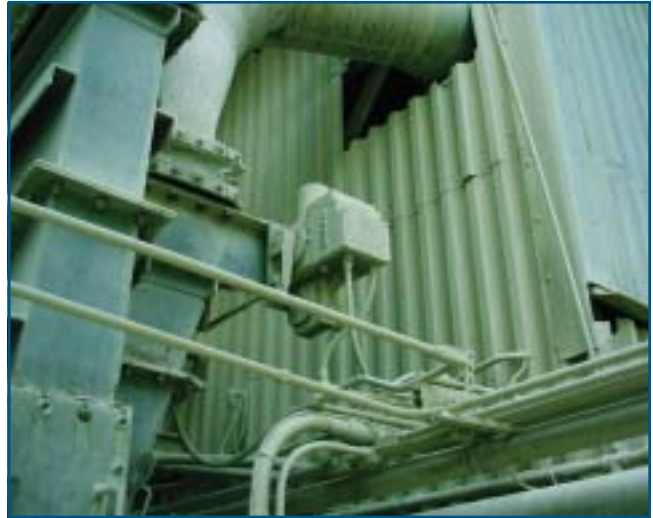
Kiln Reverse Air Fan Damper
