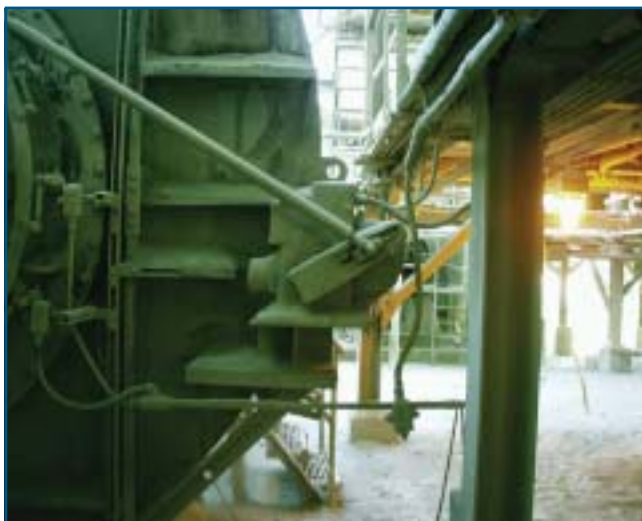
Kiln ID Fan Damper
