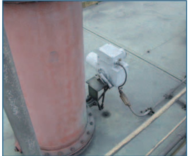
Kiln Reverse Air Fan Damper
